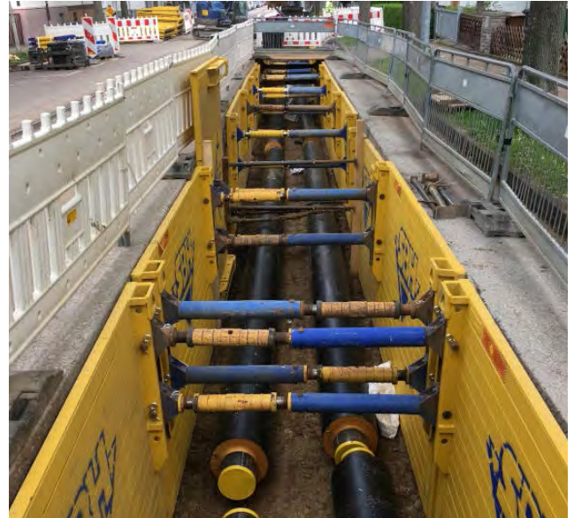
Fünf Kilometer Wärmeleitungen ziehen sich durch Ludwigsburg. Angeschlossen sind Haushalte in Neubaugebieten, in der Innenstadt und in der Nachbarstadt Kornwestheim. Foto: Stadt Ludwigsburg
