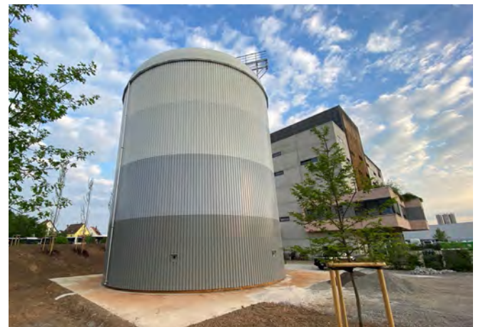
Im 20 Meter hohen Wärmespeicher wird die Solarwärme gespeichert. Im Bildhintergrund das Biomasse-Heizkraftwerk. Foto: Stadtwerke Ludwigsburg-Kornwestheim
