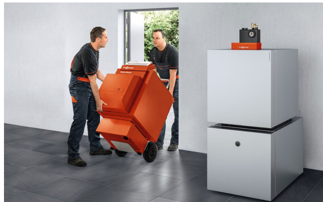
Der alte Heizkessel raus, der neue rein: Bei einem Heizungstausch sollte man frühzeitig überlegen, ob nicht gleich auch von fossilen auf regenerative Brennstoffe gewechselt werden soll. Foto: Viessmann.
