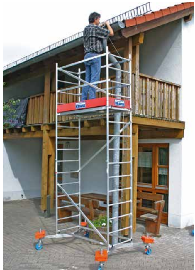
Arbeiten an Dach und Regenrinne lassen sich so bequem erledigen. Unten sind die orangenen Ballastgewichte zu sehen, die für Kippsicherheit sorgen.
