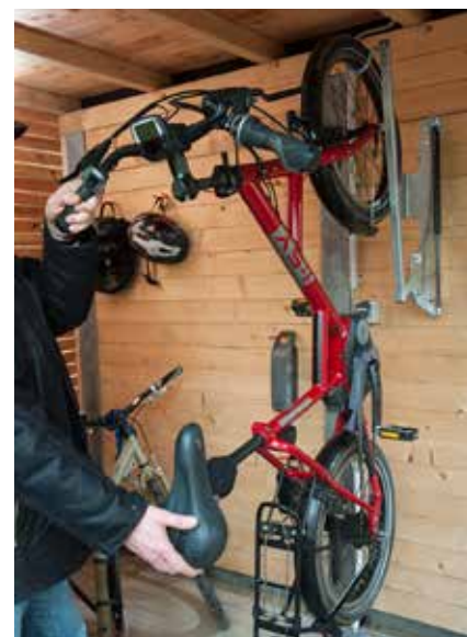
30. Zuletzt geht's an die Innenausstattung. Wir haben den Bikeport mit kraftigen Fahrradliften mit Gasdruckfeder ausgestattet, die die schweren E-Bikes tragen.
